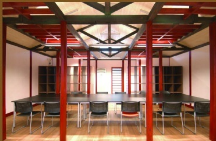
柱は交換していますが、小梁組みは既存部材を利用しています。
