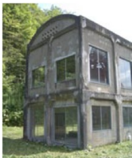
開閉所 美唄炭坑の電力をここで管理していた
