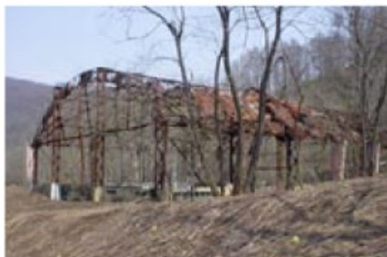
小学校の体育館は鉄骨だけが残っている (夏はスズメバチの巣があり要注意)
