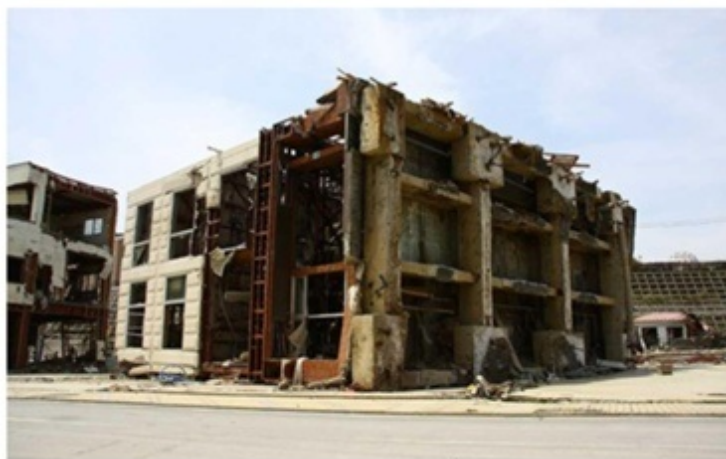
「震災発」東日本大震災の建物・施設被害
